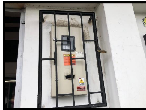
MEDIDOR DE ENERGÍA
