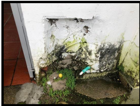
CAJA MEDIDOR DE GAS
