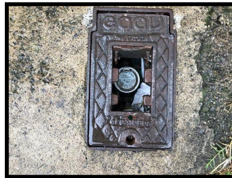
MEDIDOR DE AGUA
