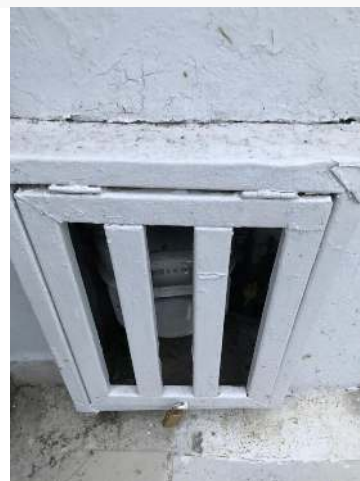
CONTADOR DE GAS
