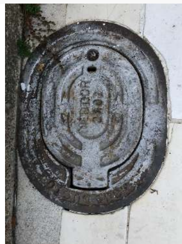
CONTADOR DE AGUA
