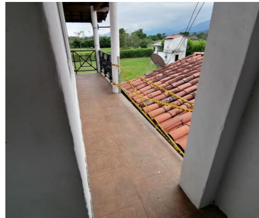
BARANDA CAIDA EN CORREDOR DEL PISO 2
