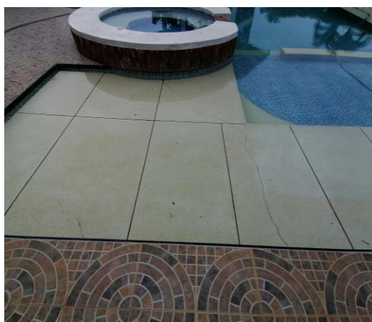
AGRIETAMIENTOS EN PISCINA
