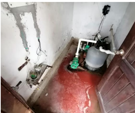
CUARTO DE MAQUINAS
