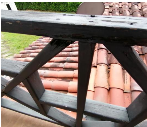
BARANDAS CORREDOR PISO 2 EN MAL ESTADO
