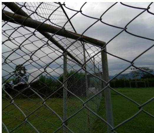
REJAS OXIDADAS EN MAL ESTADO
