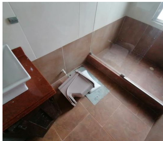
BAÑO SIN UNIDAD SANITARIA
