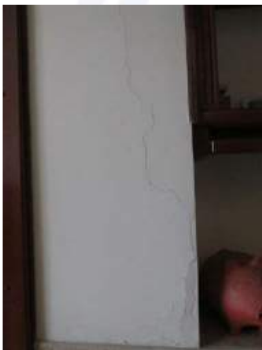
Imagen 35. Fisuras en mampostería e:1 mm
