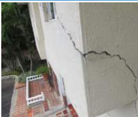
Imagen 23. Grieta en fachada e:8 mm
