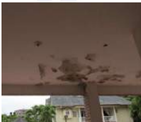
Imagen 38. Humedad en losa parqueadero.
