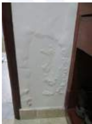
Imagen 27. Humedad en parte inferior de mampostería.
