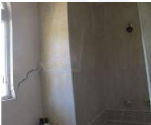
Imagen 21. Grieta en fachada Eje F
