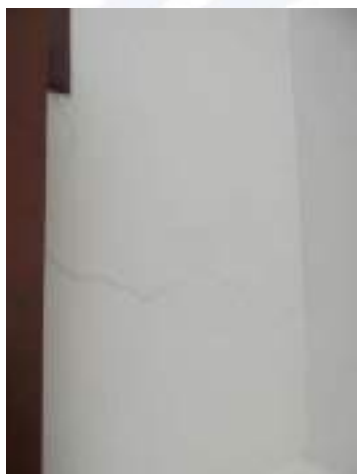
Imagen 31. Fisuras en mampostería e:1 mm
