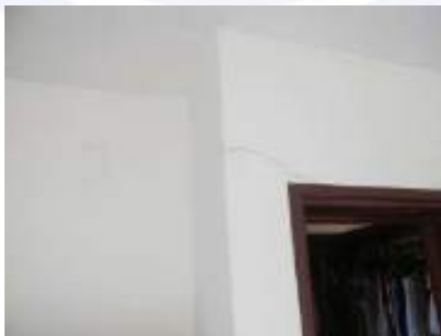
Imagen 33. Fisuras en unión mampostería L:35 cm en eje 02.
