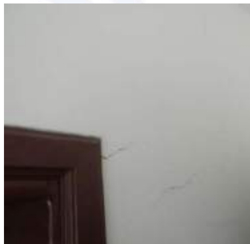
Imagen 32. Fisuras en unión mampostería L:25 cm e:1.2 mm.
