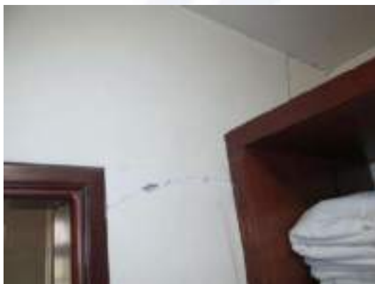
Imagen 26. Fisura desde el marco de puerta hasta la losa de entrepiso.
