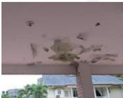
Imagen 39. Descascara miento de acabados en losa maciza parqueadero.
