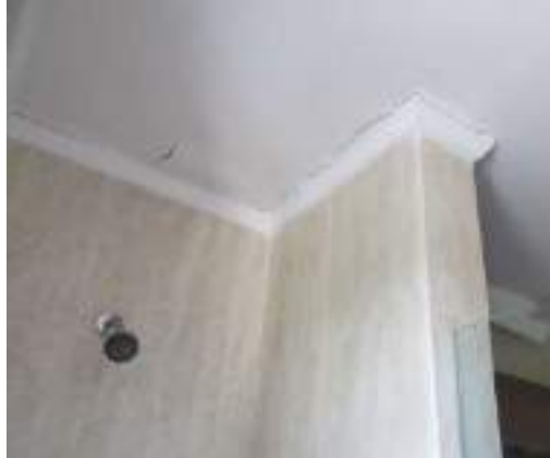
Imagen 22. Grieta en fachada Eje 10
