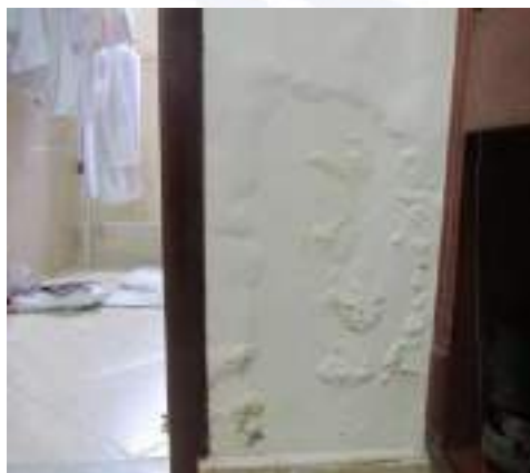
Imagen 28. Humedad en parte inferior de mampostería.
