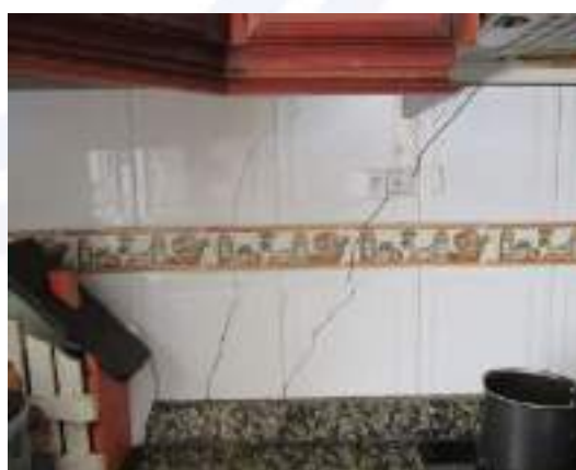
Imagen 19. Fisura en mampostería.
