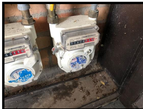
MEDIDOR DE GAS
