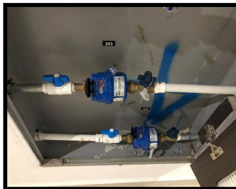
MEDIDOR DE AGUA
