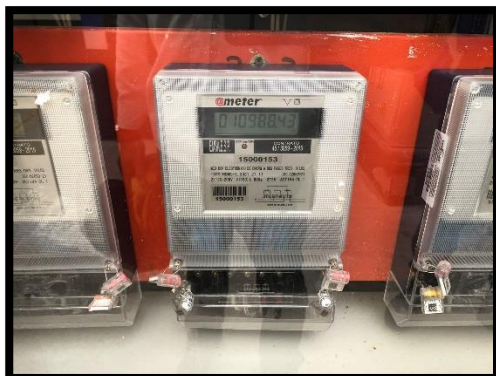
MEDIDOR DE ENERGÍA
