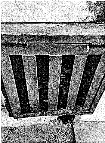
CONTADOR DE GAS
