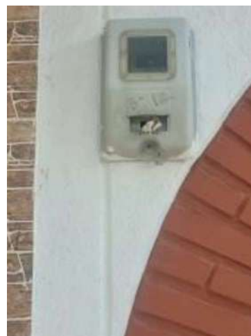
ACOMETIDA Y CONTADOR DE ENERGIA
