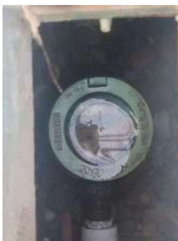
ACOMETIDA Y CONTADOR DE ACUEDUCTO
