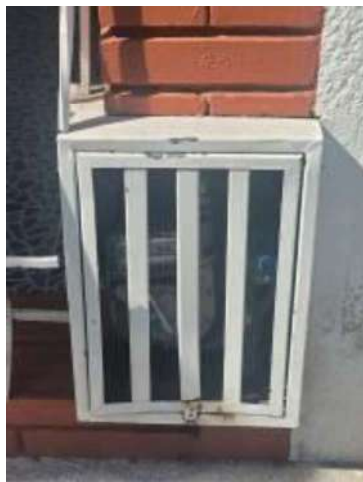
ACOMETIDA Y CONTADOR DE GAS
