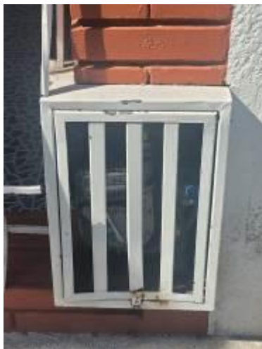
ACOMETIDA Y CONTADOR DE GAS
