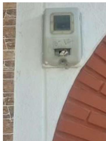
ACOMETIDA Y CONTADOR DE ENERGIA
