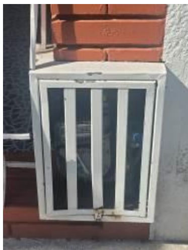
ACOMETIDA Y CONTADOR DE GAS
