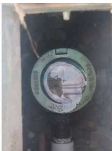
ACOMETIDA Y CONTADOR DE ACUEDUCTO
