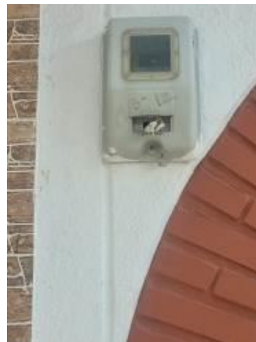
ACOMETIDA Y CONTADOR DE ENERGIA
