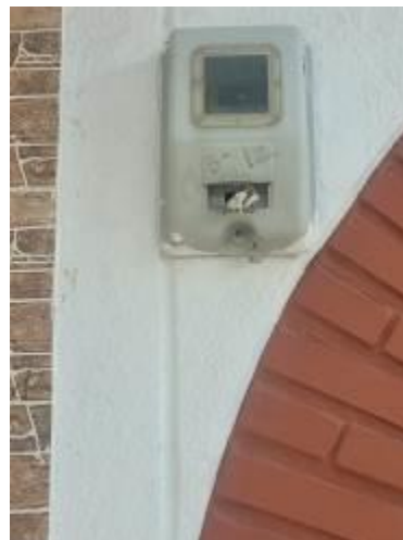
ACOMETIDA Y CONTADOR DE ENERGIA
