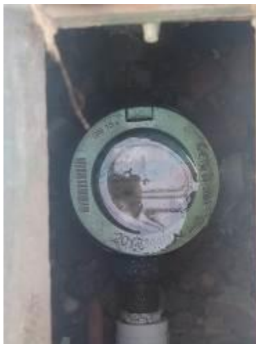
ACOMETIDA Y CONTADOR DE ACUEDUCTO
